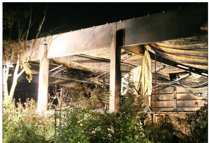
Gespentisch: die ausgebrannte Halle am späten Abend im Scheinwerferlicht der Feuerwehr.
